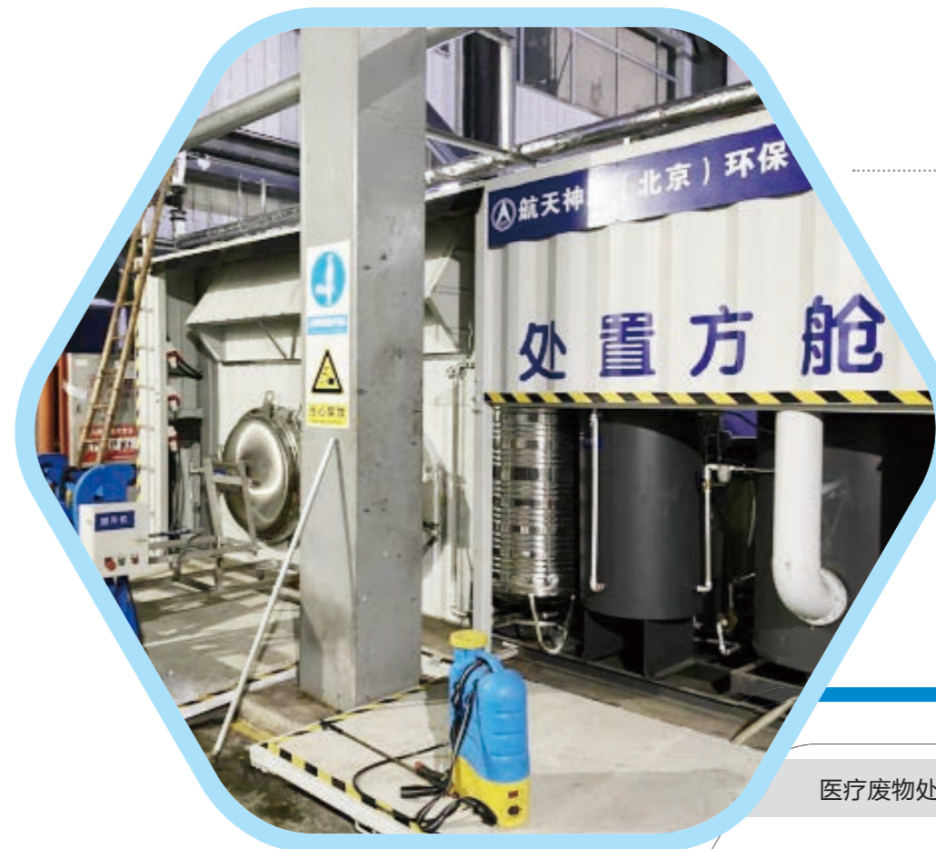
海宜医废公司 医疗废物处置方舱
