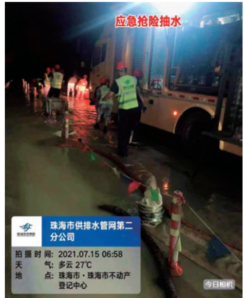
石景山隧道“7·15”重大透水事故现场，邹鹏和班组人员正在抢救当中
